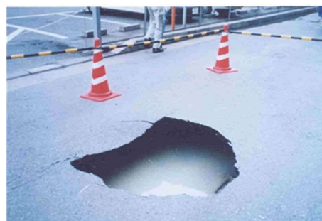
道路陥没件数の推移と陥没例
